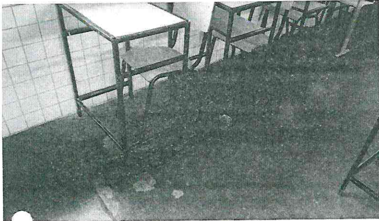
Piso da sala de aula com perfurações
